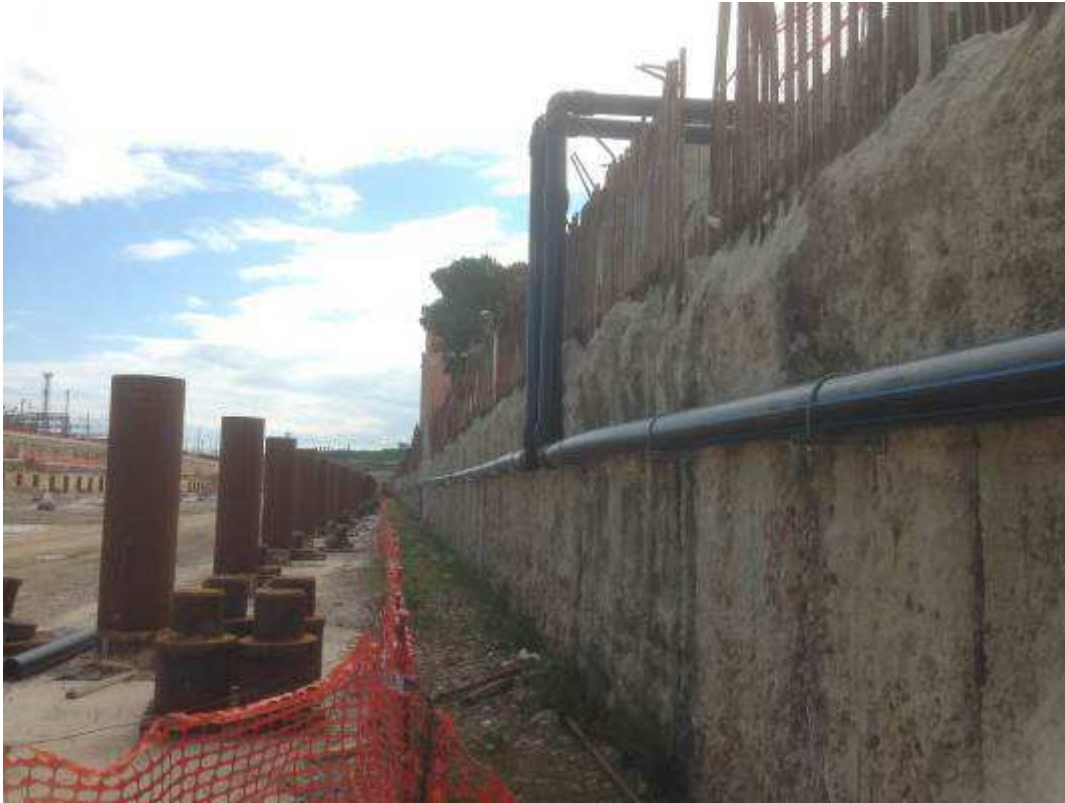
Foto 2 - Impianto di aggottamento acque interno camerone
