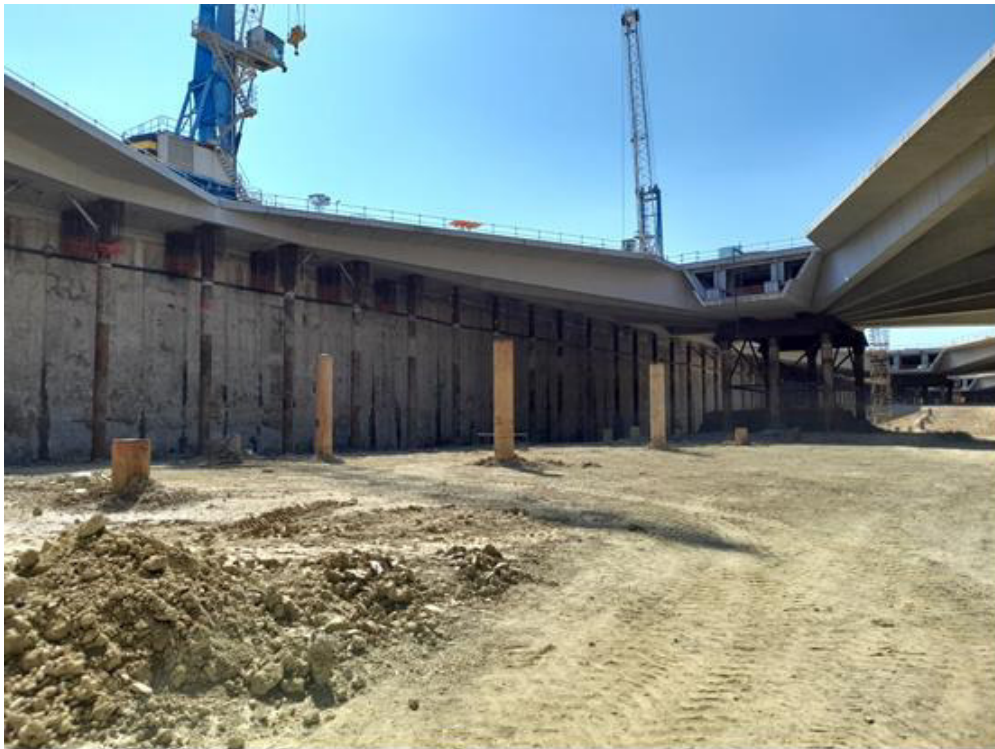
Abbassamento fondo scavo Nuova Stazione AV tra i fili 10 e 16 (quota scavo 30,50 m. s.l.m)
