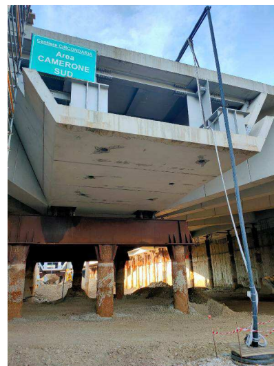
Particolare dell'intradosso del solaio. Si nota il "vano" con funzione di via di esodo in caso di emergenza
