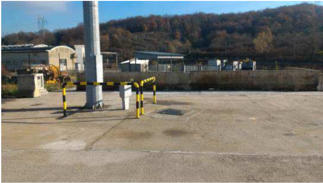
Foto 1 – Vasca di Prima Pioggia – NC177
