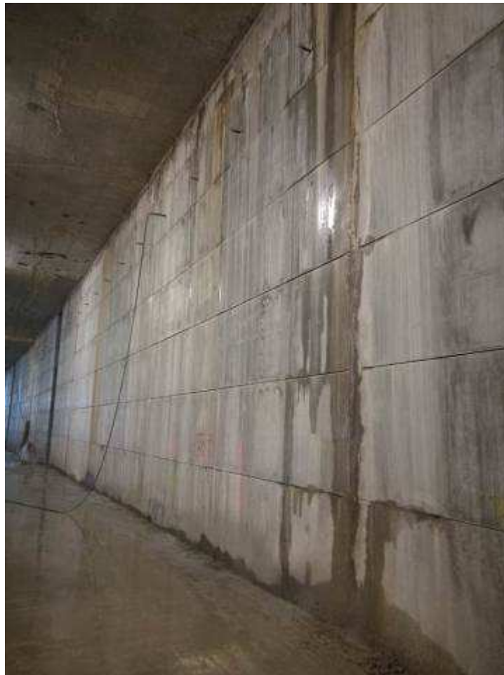
Foto 1 – Risoluzione NC184 e 185 – Area Ex Scavalco
