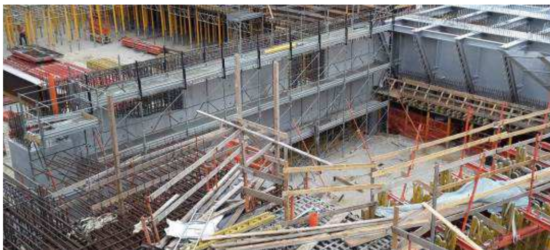
Foto 7 – Scassero Trave TPT01 Testata Sud - lato Est
