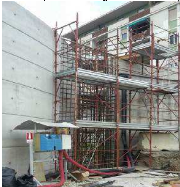
Foto 9 – Montaggio armatura, cassetatura e getto Muro di raccordo con MU4bis, Rampa Kiss&Ride
