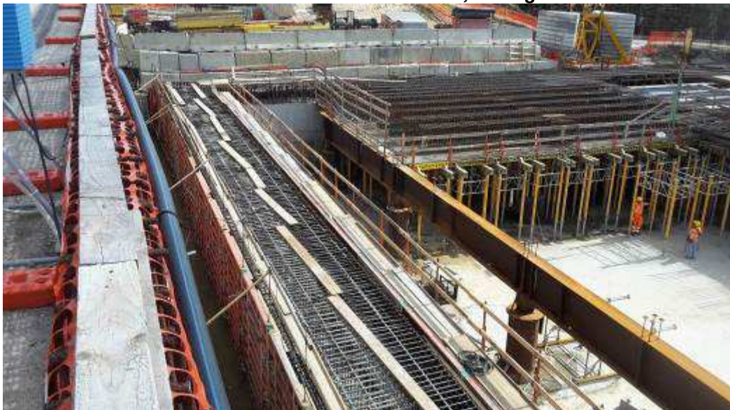
Foto 6 – Montaggio Casseratura e getto Cordolo di testa Diaframmi Lato Est, Zona T. Sud
