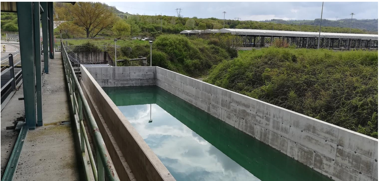
Figura 29 - S. Barbara: Vasca di sedimentazione acque collina
