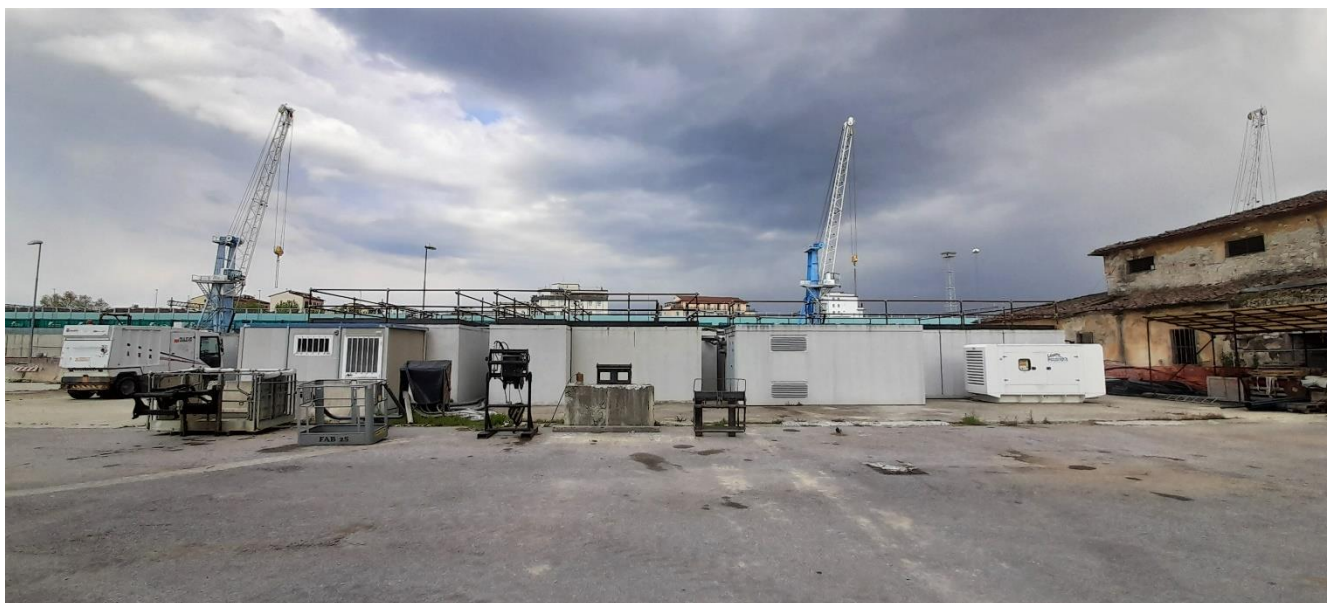
Figura 21 - Impianto di trattamento acque meteoriche
